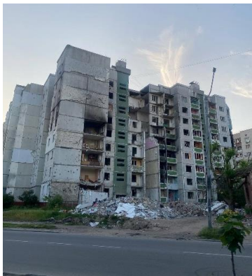
Рис. 1 Будинок на вул. В'ячеслава Чорновола, який зазнав бомбардування 3 березня 2022 року. Фото 9.06.2022
