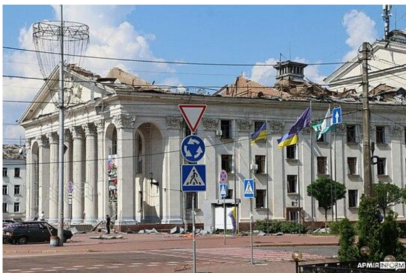
Рис. 3. Зруйнована покрівля обласного драматичного театру [1]
